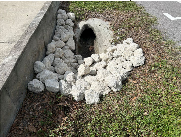
S. Barfield Dr. washout repair.
